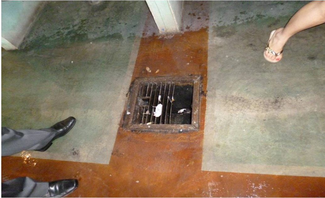
Área de pilas del módulo en donde se parecía la rejilla en mal estado.
